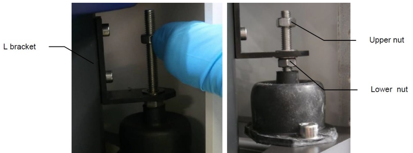
Figure 5.13: The AV mounts and L-brackets
